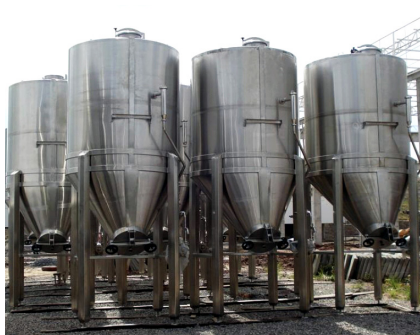
Dornas de fermentación, instalaciones en vasos comunicantes.
