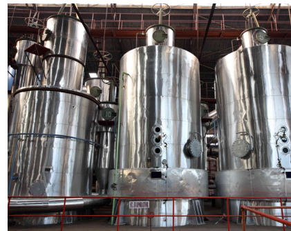
Evaporadores, instalaciones en vasos comunicantes.
