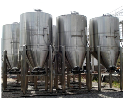
Dornas de fermentación, instalaciones en vasos comunicantes.
