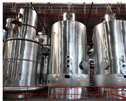
Evaporadores, instalações em vasos comunicantes.
